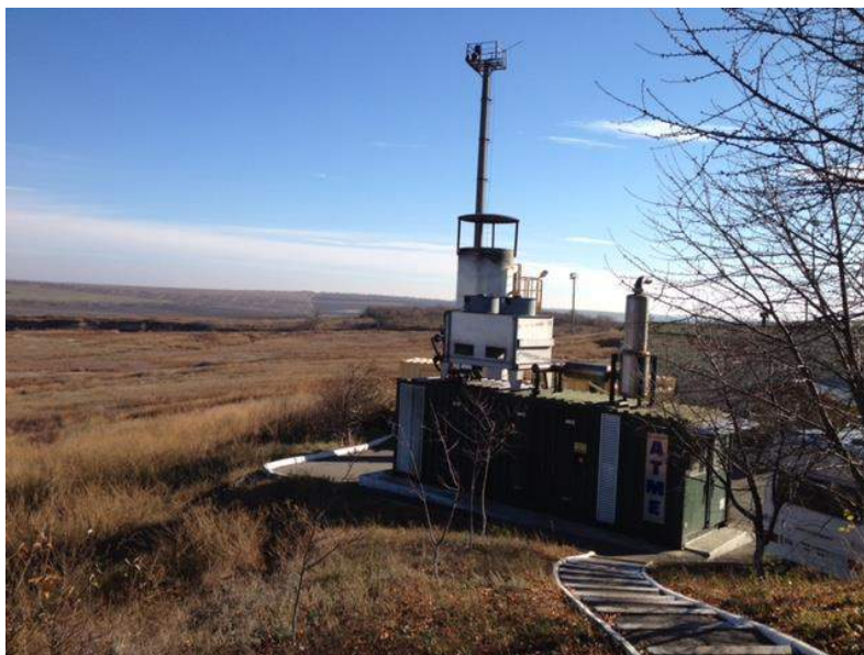
Figura 1-9 Stația Biogaz de la rampa de gunoi de la Țințăreni
