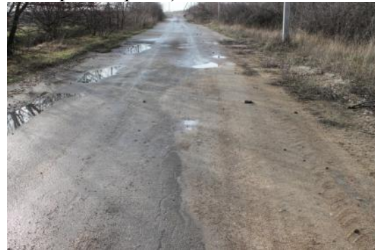
Deteriorarea parțială a structurii drumului
