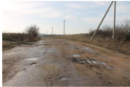
Gropi in suprafața drumului deteriorat
